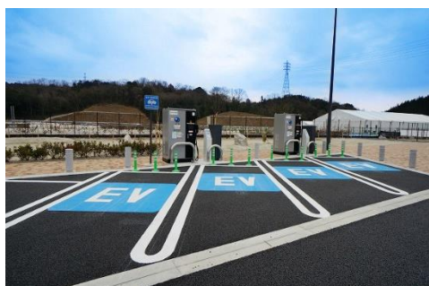
電気ステーション（新東名高速道路 岡崎SA）
