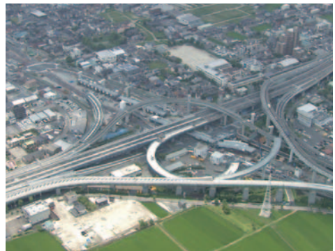
名古屋環状2号線 名古屋西JCT建設現場 (国土交通省中部地方整備局提供)
