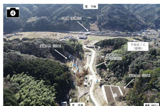
施工状況(河津下田道路Ⅰ期) 出典：沼津河川国道事務所HP
