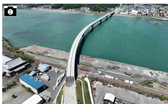
② 施工状況(新宮紀宝道路) 出典:近畿地方整備局HPより
