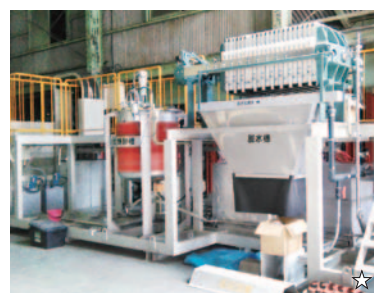
本社工場に設置されている研究開発用のエタノール製造プラント
